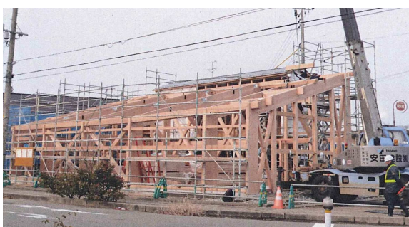
中断面集成材 片側ラーメン・ブレース工法による建て方
